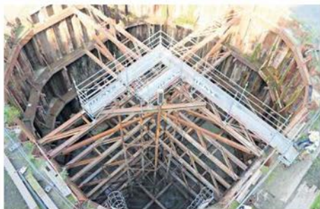
Met 30 meter lange damwandplanken wordt een tijdelijke kistdam in het kanaal gevormd.
